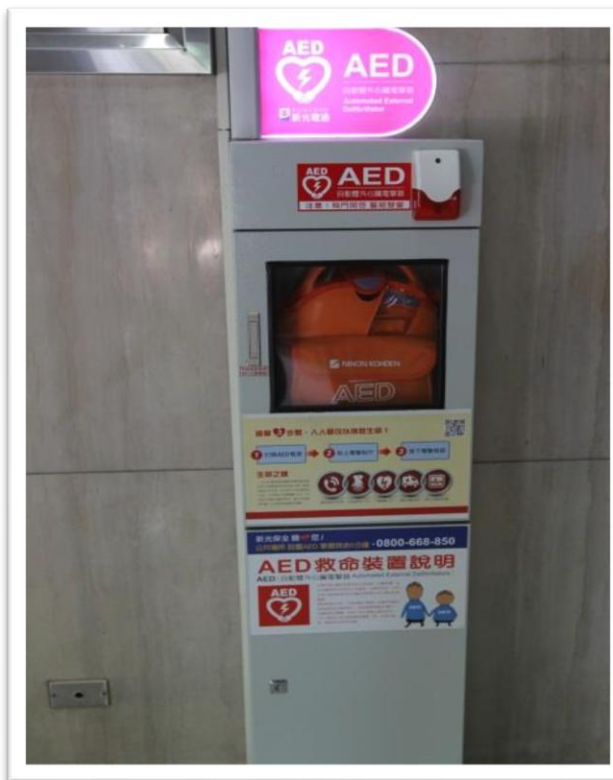
1樓大廳設置AED
